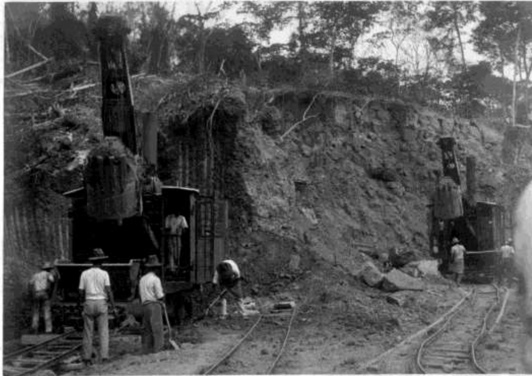
14. Puerto Prévano/Útica Km 36 2 Greifbagger beim Wegräumen einer Rutschung.
